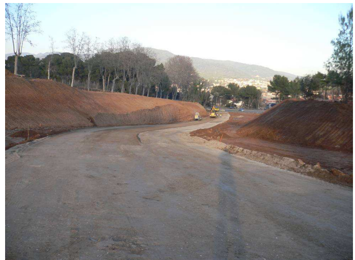
Base de zahorra reciclada mixta 0-20mm. en la variante de la C-17 en Barcelona, con material suministrado por Tecnocatalana de Runes.
